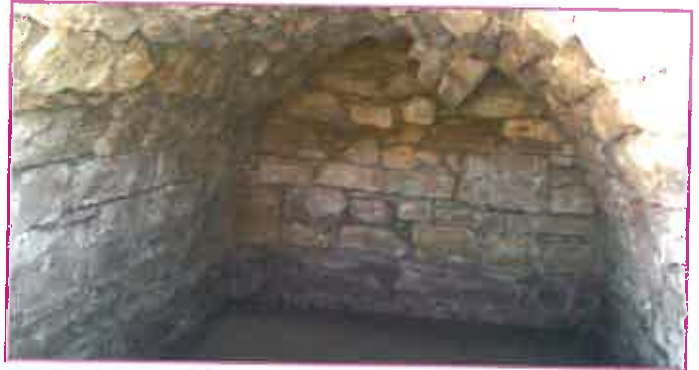
Interior del pozo, en el que se observa cómo empieza a hundirse la bóveda.
